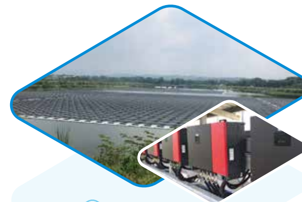
台湾嘉義中埔鄉 20Mw水面型光伏发电项目
