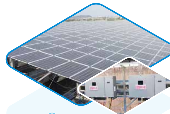
汕头新溪 2Mw光伏发电项目
