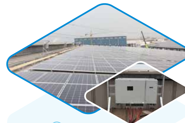
佛山三水 4.2Mw光伏发电项目
