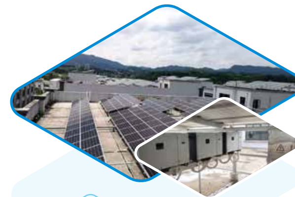
湖南怀化 6Mw光伏发电项目
