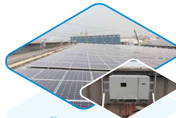
佛山三水 4.2Mw光伏发电项目
