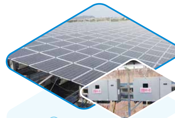
汕头新溪 2Mw光伏发电项目
