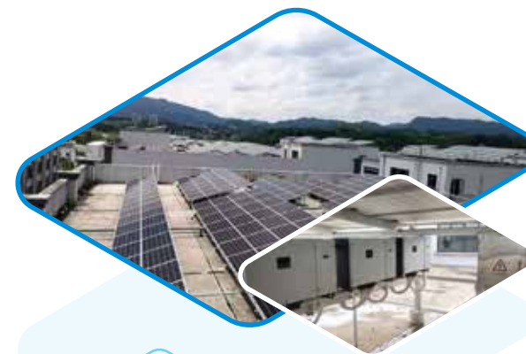
湖南怀化 6Mw光伏发电项目
